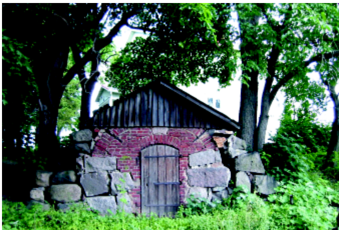
Opastuskeskuksen tontilla sijaitseva vuonna 1836 rakennettu maakellari kaipaa kipeästi kunnostusta.
